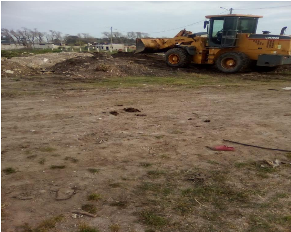
Foto 38: Relleno con piedra y tosca del predio. Maquina trabajando en desparramar para equiparar nivel.
