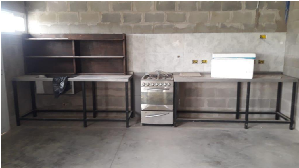
Avances en las terminaciones de la cocina: cocina, cableado eléctrico y conexión de agua (Foto 30)
